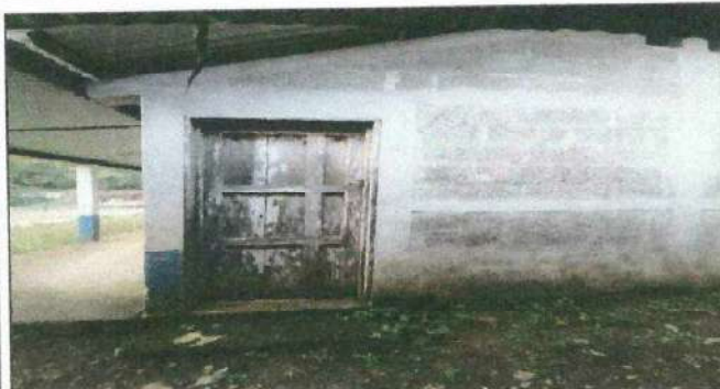
Foto 3: SUSTITUCION DE PUERTA DE MADERA EN MAL ESTADO
