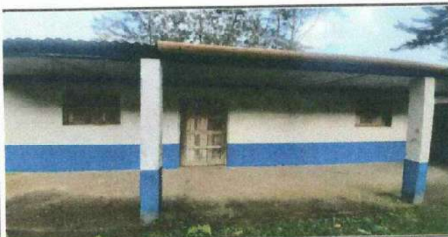
Foto 5: SUSTITUCION DE VENTANAS Y PUERTA DE MADERA QUE SE ENCUENTRAN EN MAL ESTADO
